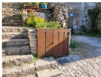
Exemples – compteur électrique
