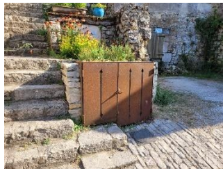
Exemples – compteur électrique
